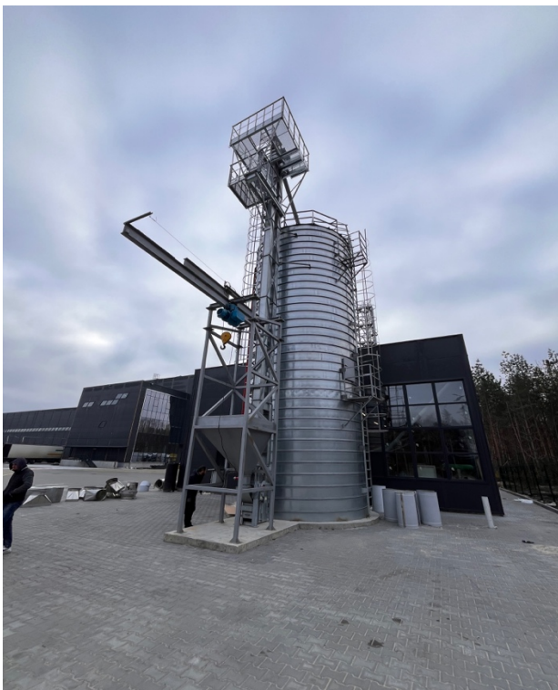
НОВА ПОШТА м. Київ 2023 рік Комплекс для забезпечення роботи котельні. Силос для пелет 150 м 3
