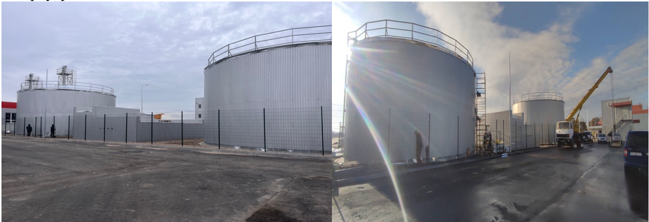
Резервуари пожежні 700 м 3 2 шт.
